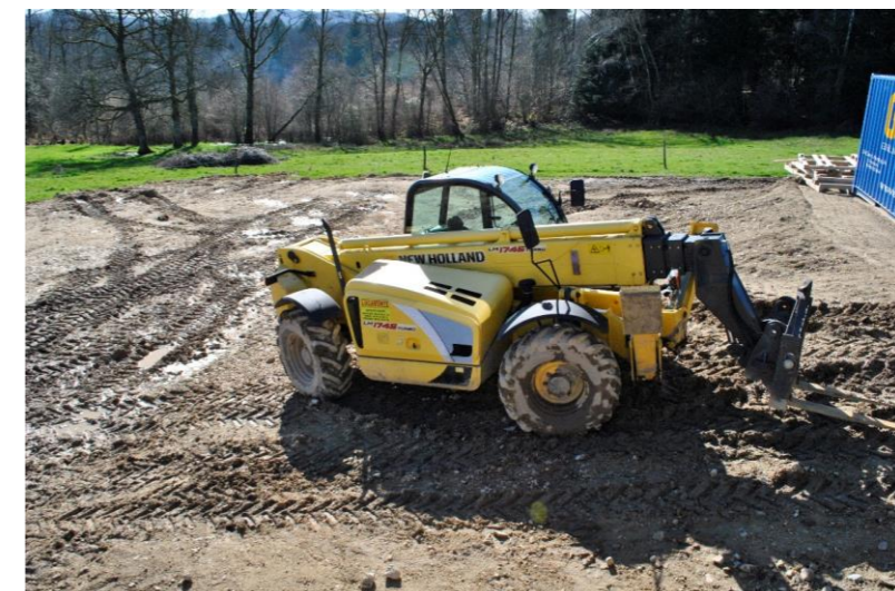
Photographie 25 : Exemple de tassement et d'ornières créés par les engins de chantier
